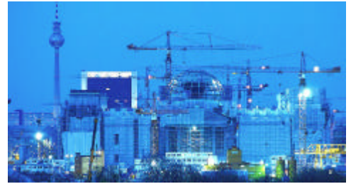
Umbau des Reichstagsgebäudes in Berlin 20.000m 2 3S-Hohlraumboden
